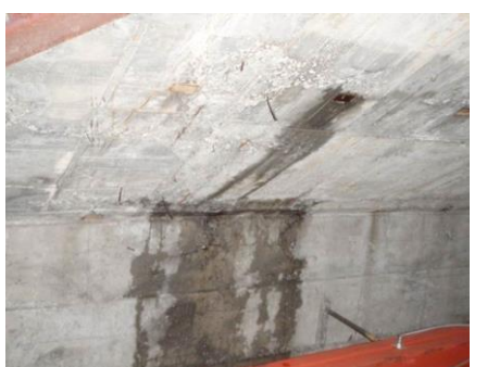
屋根下地面からの雨漏り
