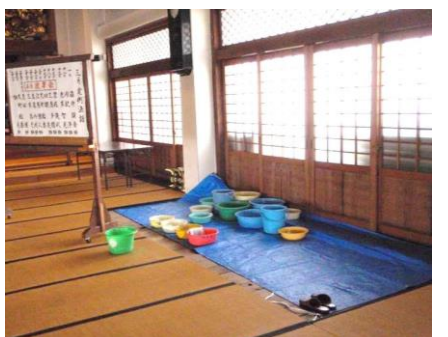
本堂東側の雨漏り
