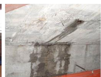
屋根下地面からの雨漏り
