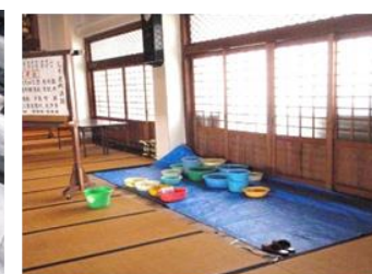
本堂東側の雨漏り
