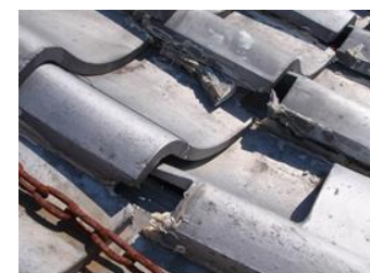
屋根瓦のズレ・破損
